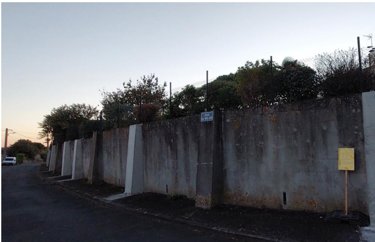
Photo 1 : les contreforts situés à l'est de la parcelle 189 n'ont aucun usage pour le public
